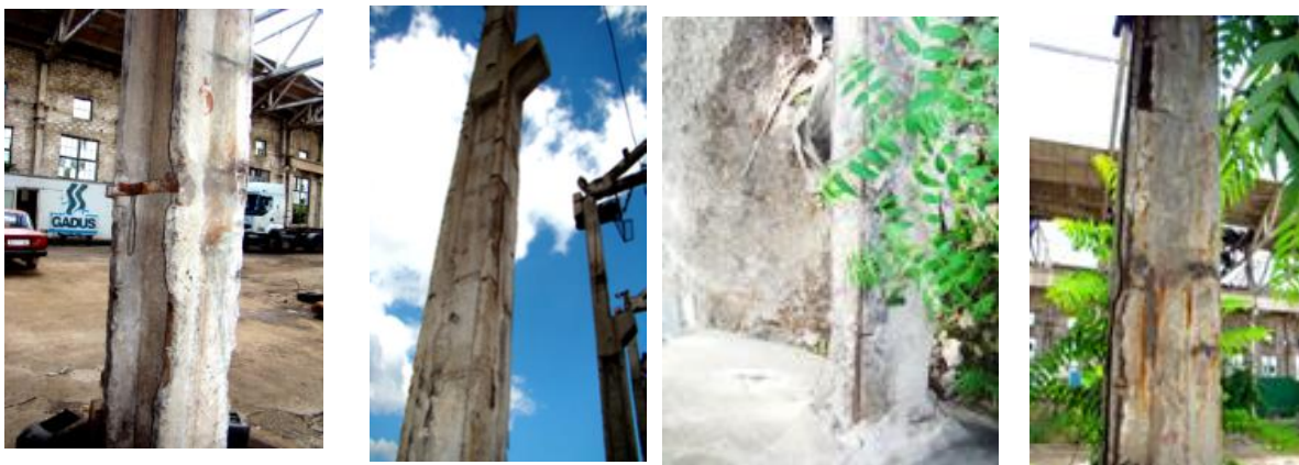
Рис. 1. Приклади пошкодження залізобетонних стиснутих конструкцій складного профілю
