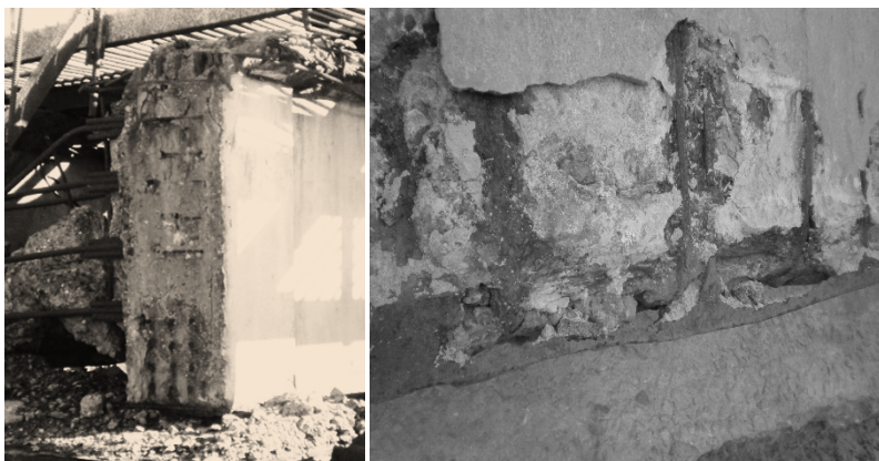
Фото. 1;2. Фактическое состояние тавровых балок
