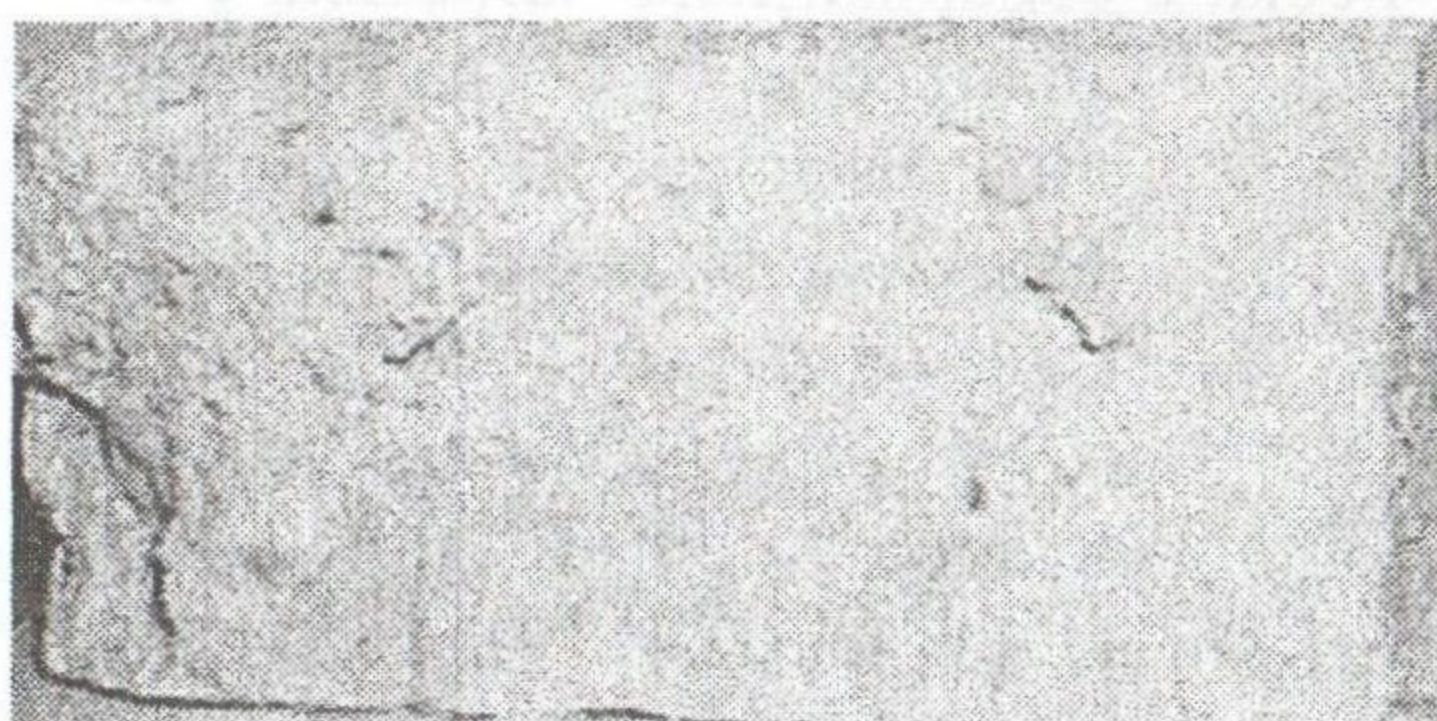
Рис.3. Воздействие сульфатной коррозии на силикатный кирпич.
