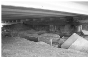
Фото 3. Разрушение конусов устоев
