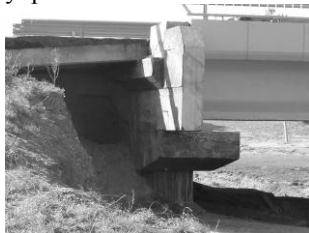
Фото 4. Разрушение переходной плиты
