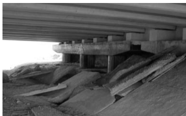
Фото 2. Разрушение укрепления устоев
