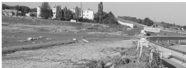
Фото 6. Вынос железобетонных элементов моста вниз по логу
