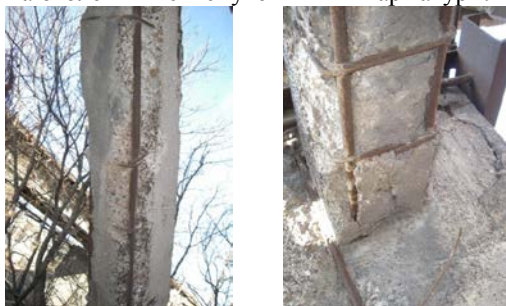
Рис. 1. Фото пошкоджень опор шляхопроводу в місті Одеса
