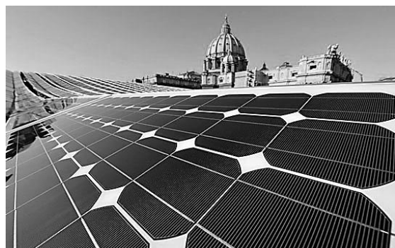
Рис. 7. Солнечная электростанция в Ватикане
