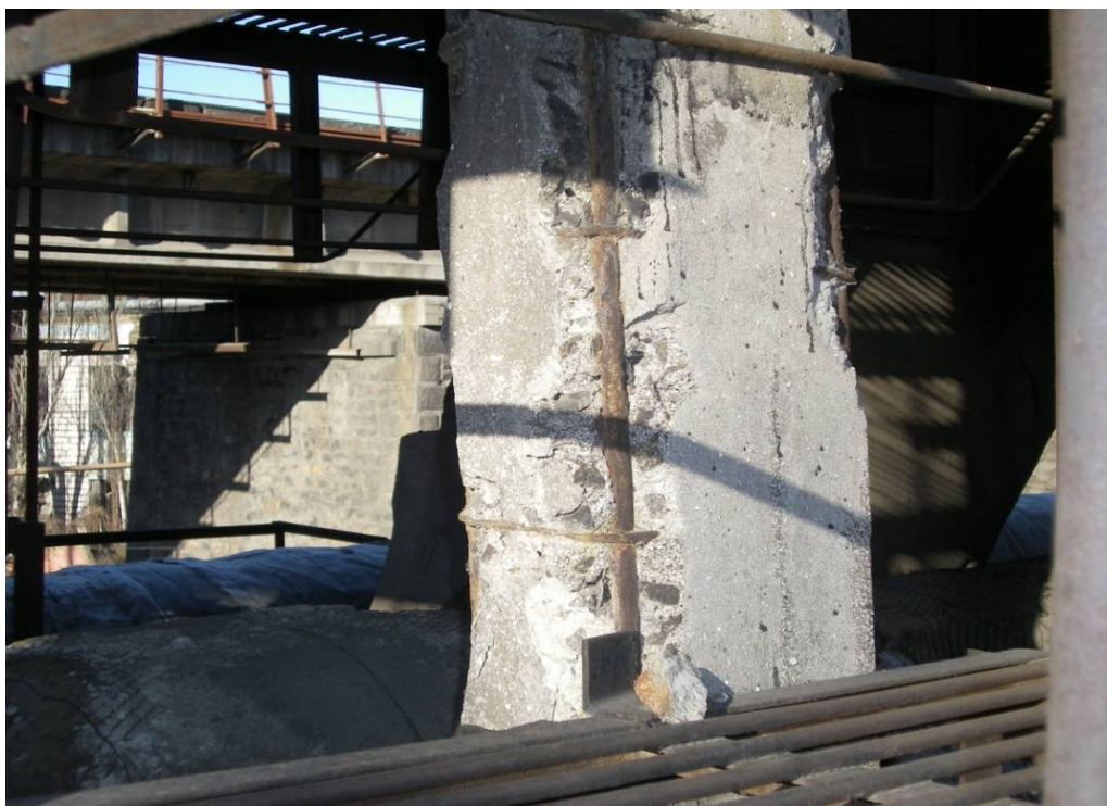
Рис 1.1. Разрушения сжатых железобетонных элементов, г. Одесса.
