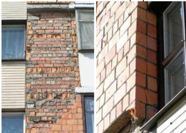
Рис. 1.2. Обвалення та деформування облицювального шару несучих простінків
