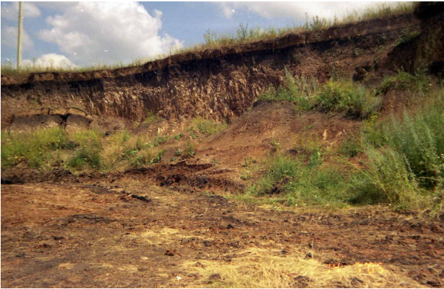
Рисунок 1 – Оползень на дороге «Красные Окны – Новосамарка»
