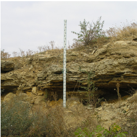
Рисунок 3 – Слой известняка в выемке на автомобильной дороге «Одесса – Вознесенск – Новый Буг»
