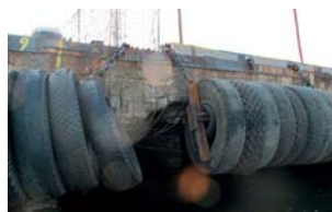
Рис.5. Повреждение бортовой балки в надводной зоне (Черноморск)
