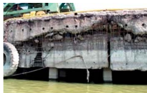
Рис.4. Повреждение бортовой балки в надводной зоне (причал 8 Измаил)
