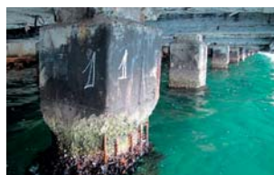
Рис. 2. Повреждение сваи в зоне переменного увлажнения (причал 23 Черноморск)
