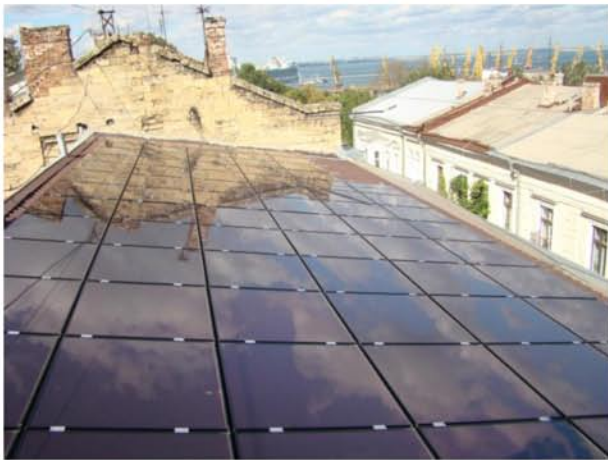
Рис.3. Солнечная термофотоэлектрическая система на крыше в Одессе
