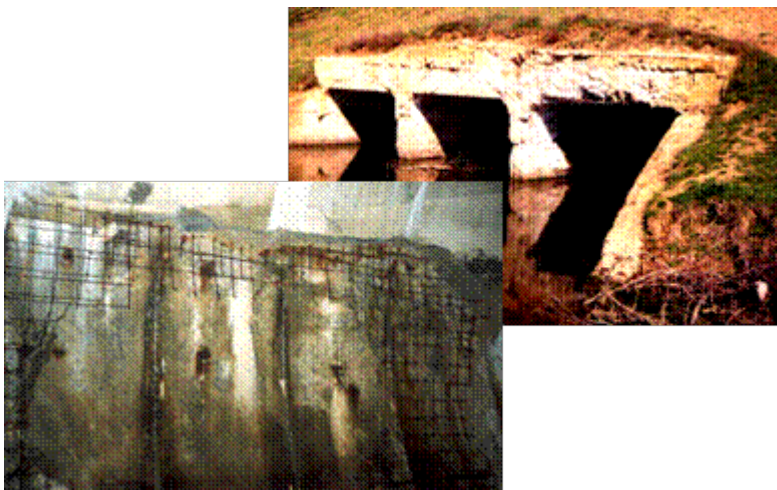
Рис.1. Примеры разрушения бетона гидротехнических сооружений мелиорации
