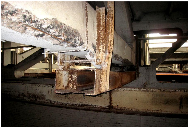
Рис. 2. Сколы и трещины в нижнем поясе ферм покрытия
