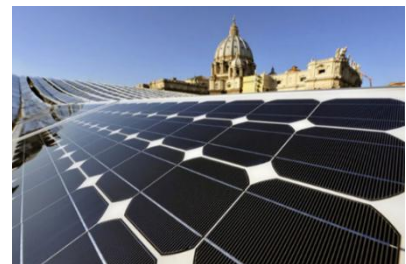
Рис. 18. На крыше Ватикана солнечная электростанция
