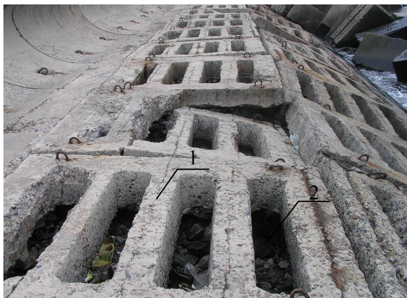
Рис. 4. Разрушение постели и откоса под железобетонной решетчатой плитой: 1 – решетчатая плита, 2 – пустоты из-за выноса частиц грунта
