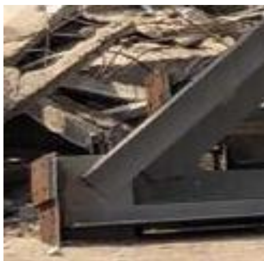
Рис. 3. Деформації опорних фланців опорних вузлів ферми
