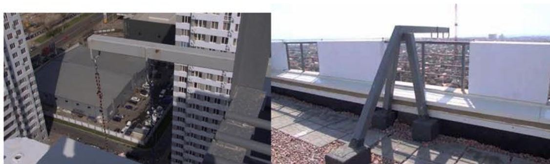
Рис. 2. Кронштейни для встановлення канатних систем порятунку
