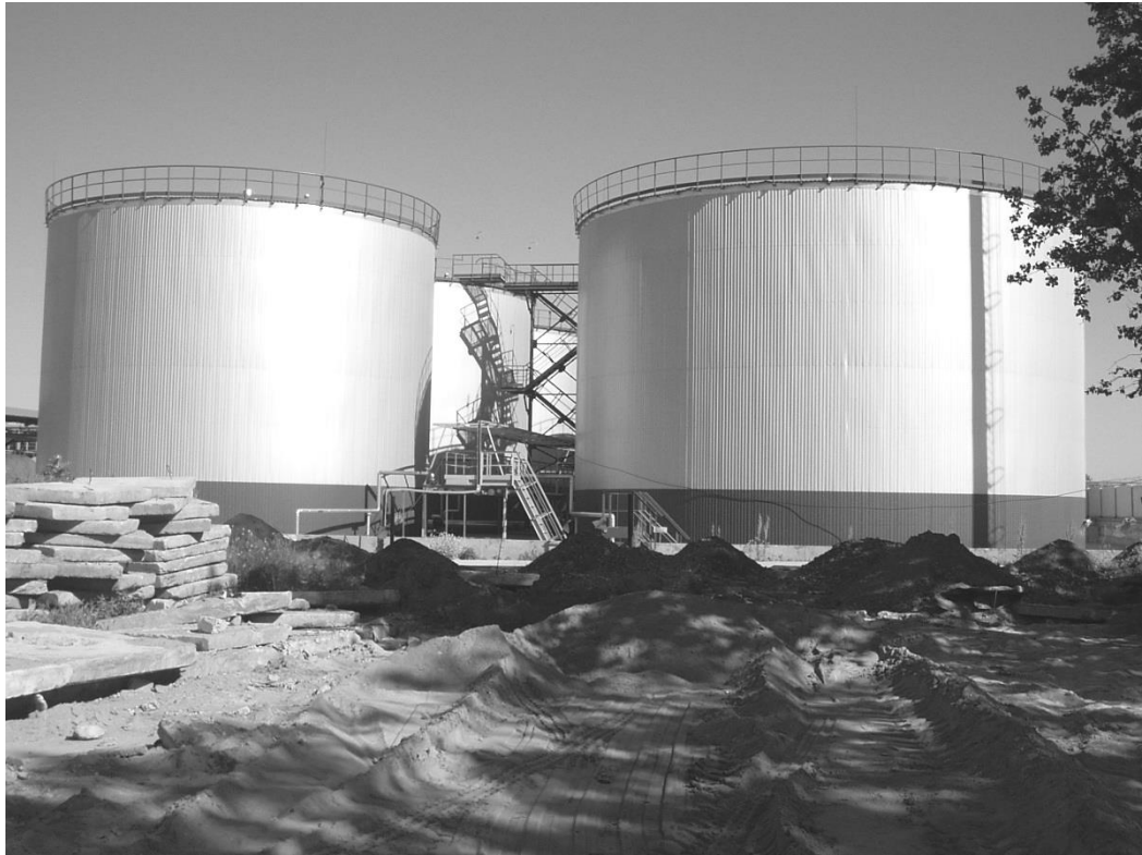
Рис. 1.1. Резервуарний парк (вид збоку)
