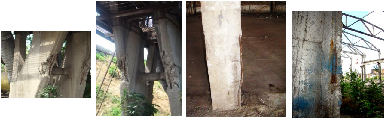
Рис. 1. Пошкодження залізобетонних конструкцій в процесі експлуатації
