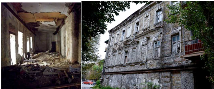
Рис.2 Состояние внутренних конструкций и боковой фасад
