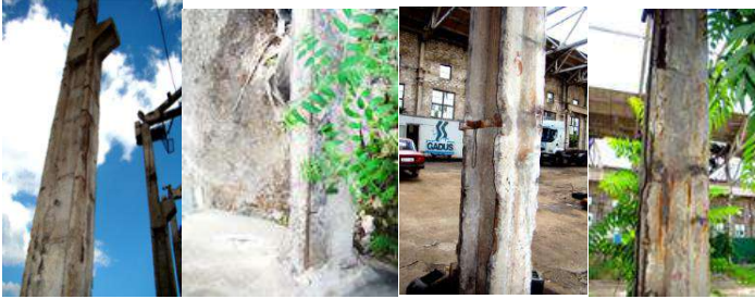
Рис. 1. Приклади пошкодження залізобетонних стиснутих двотаврових конструкцій.
