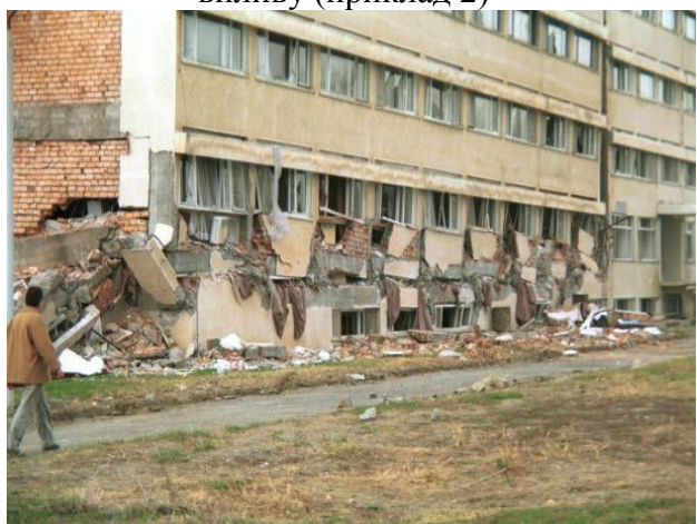
Фото 4. Руйнування каркасної будівлі по крайніх несучих колонах від сейсмічного впливу (приклад 4)
