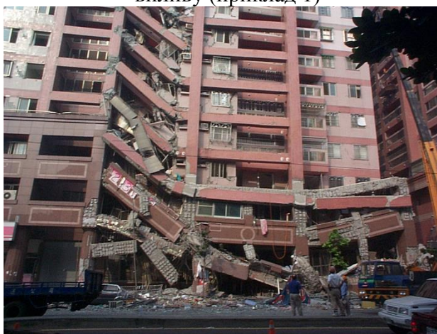
Фото 3. Руйнування каркасної будівлі по крайніх несучих колонах від сейсмічного впливу (приклад 3)
